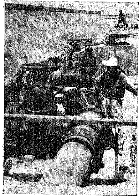
7.—El agua proveniente de El Pardillo será almacenada en un tanque regulador. En la fotografía pueden apreciarse los trabajos de instalación de las válvulas de dicho tanque.
